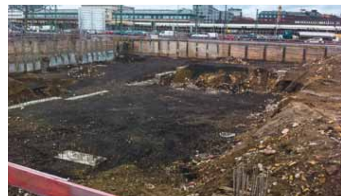
Noch ist nicht viel zu sehen vom neuen „Mobilitätshaus“, im März sollen die Arbeiten am Parkhaus jedoch weitergehen. Bild: Syri
